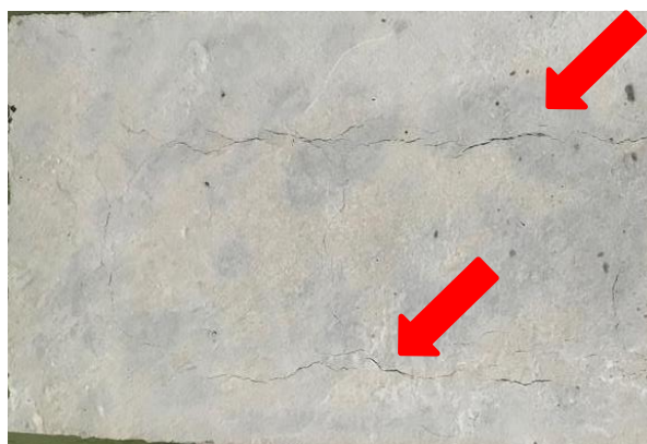
Figura 20 – Ocorrência de fissuras Fonte: Próprio Autor (2019).
